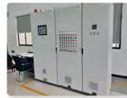
串螺污泥脱水系统 PLC 柜
