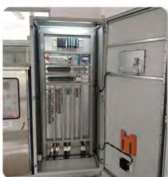
串螺污泥脱水系统 PLC 柜
