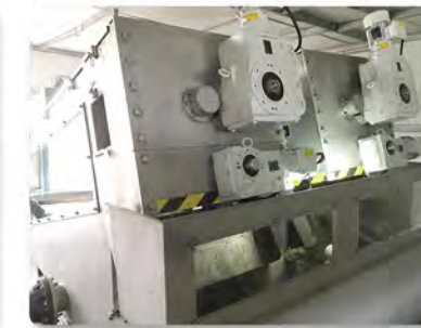
泥饼落料泥斗
