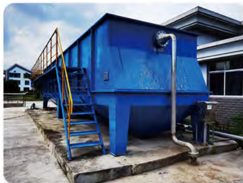
一体化斜板沉淀池
