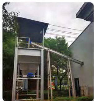
泥饼输送及存储
