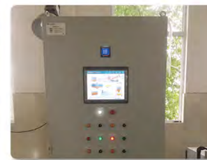
串螺污泥脱水系统 PLC 柜
